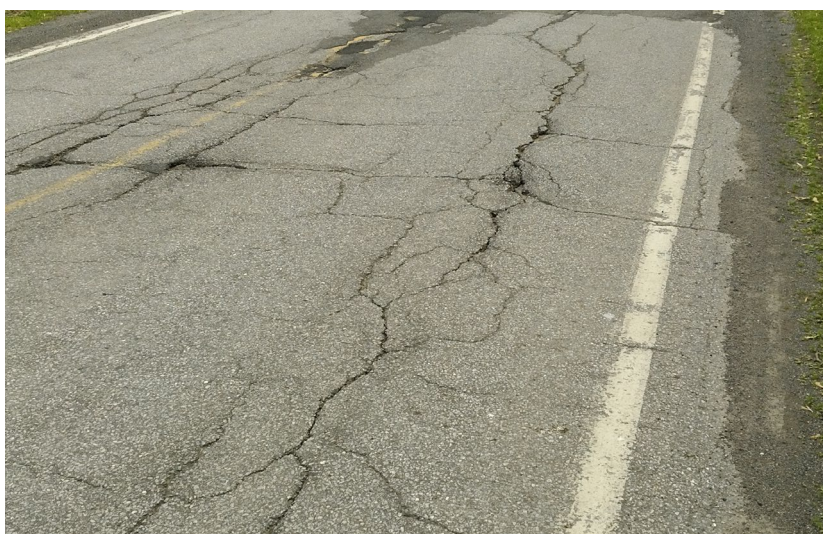
Figure 1. Exemple de revêtement détérioré – monté Bullock, Henryville
