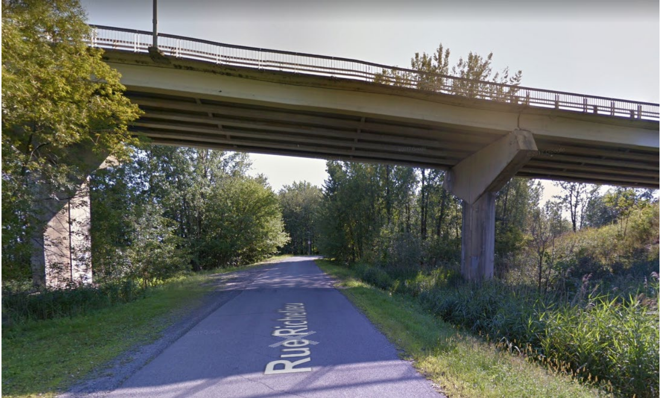
Figure 6. Absence de connexion entre la route 202 et la rue Richelieu, Lacolle
